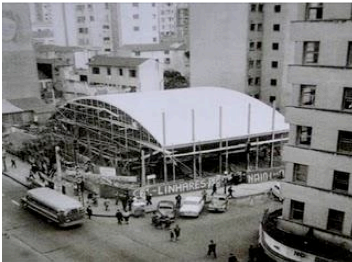
Figura 8: Pavilhão de Exposições do Governo do Estado do Rio Grande do Sul (“Mata-Borrão”) em obras. Arquiteto Marcos David Heckman, 1960. Fonte: Disponível em: http://profciriosimon.blogspot.com/2010/05/niemeyer-em-porto-alegre-04.html . Acesso em set. 2009.
