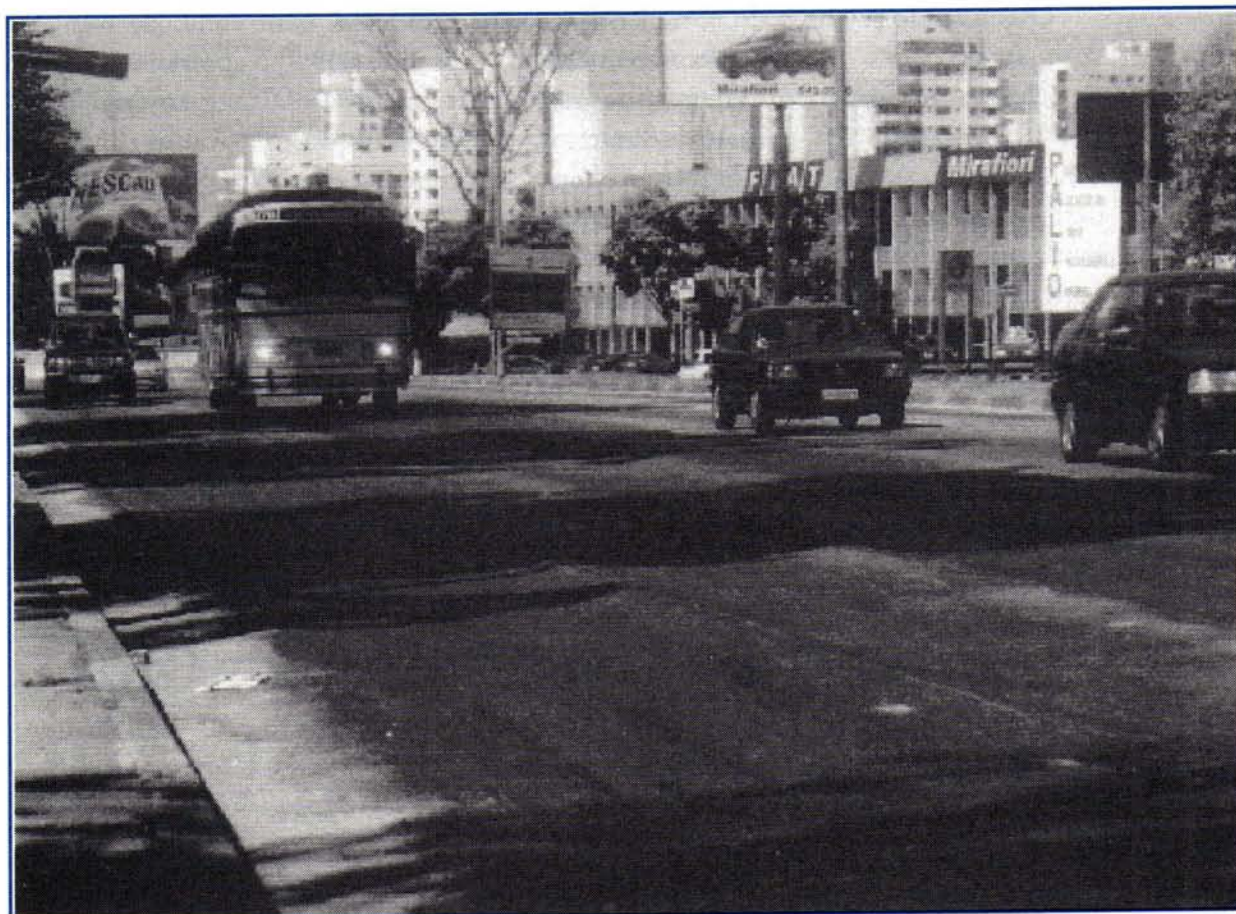
Figura 1 Afundamento na trilha-de-roda na Avenida dos Bandeirantes, em São Paulo
