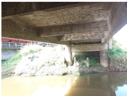
Figura 12 Inspeção do tabuleiro, das longarinas e das transversinas sobre corpo hídrico com uso de drone
