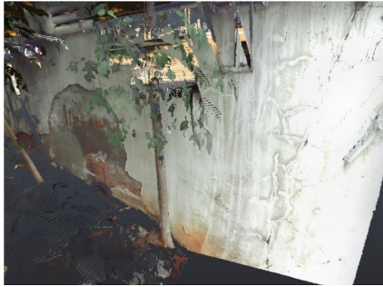
Figura 7 Fissuras na pintura e deslocamento da argamassa de assentamento nos encontros
