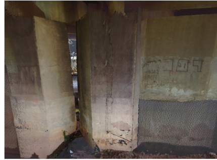
Figura 8 Fissura vertical em pilar
