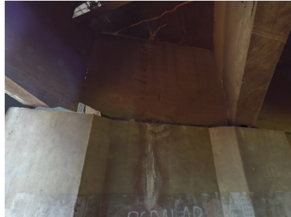
Figura 6 Mancha de umidade em pilar parede e fissuras no tabuleiro
