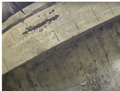
Figura 13 Foto realizada por drone de armadura exposta em longarina
