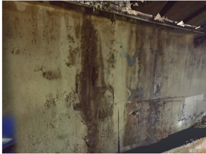
Figura 5 Presença de infiltração, com desenvolvimento de vegetação entre o pilar parede e o tabuleiro
