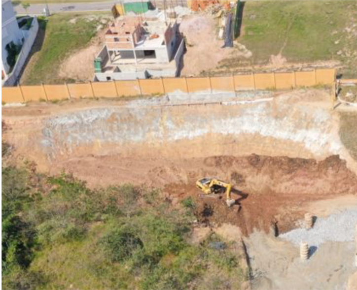
Figura 10 Edificação na crista do talude em recuperação
