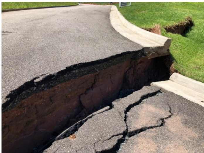
Figura 9 Pavimento próximo ao talude, com recalque devido ao segundo escorregamento ocorrido no talude em solo
