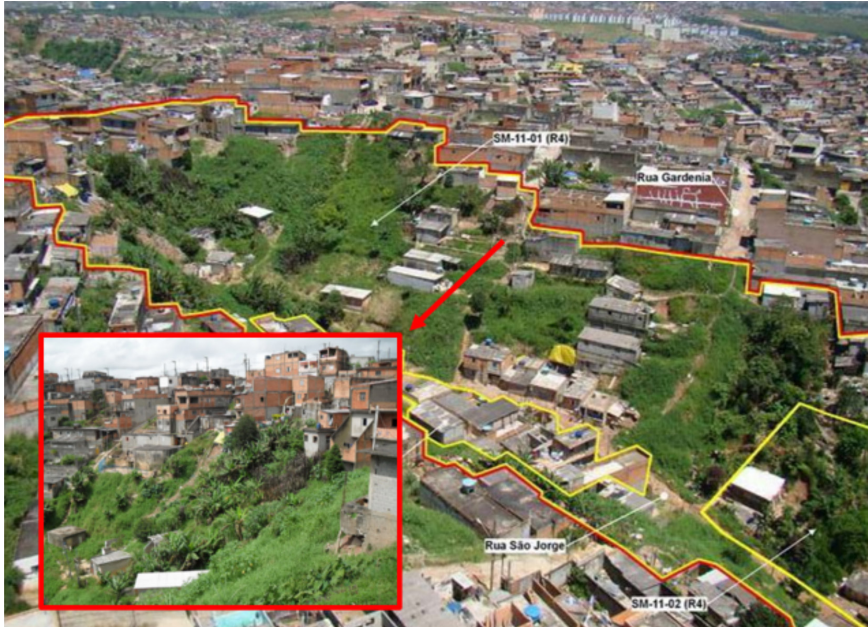
Figura 5 Vista do setor SM-11-01 mapeados com a região que necessita da obra de contenção.
